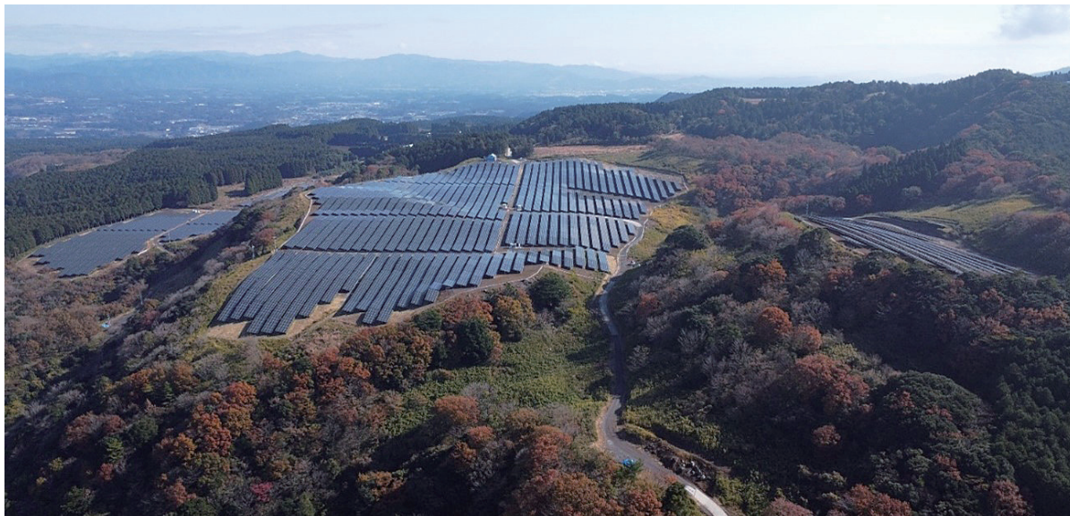
いちごえびの末永ECO発電所
