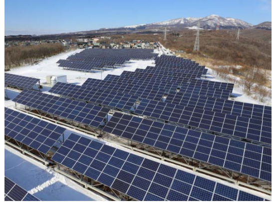
④ いちご室蘭八丁平 ECO 発電所
