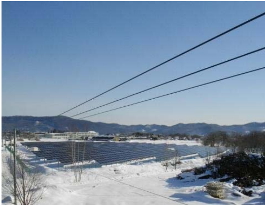
⑤ いちご遠軽清川 ECO 発電所
