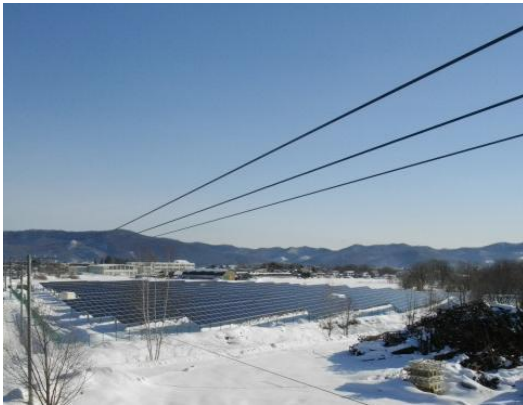
⑤ いちご遠軽清川 ECO 発電所
