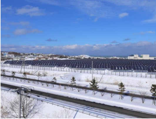
③ いちご元紋別 ECO 発電所
