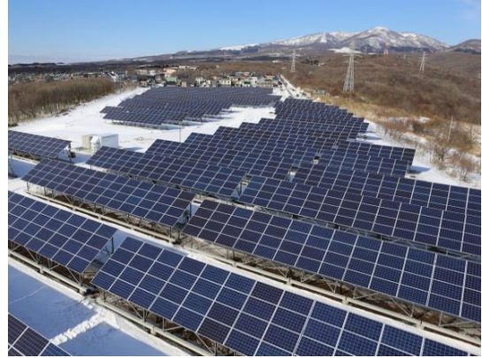
④ いちご室蘭八丁平 ECO 発電所
