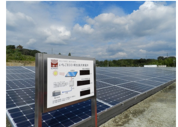
■ いちごECO桐生奥沢発電所
