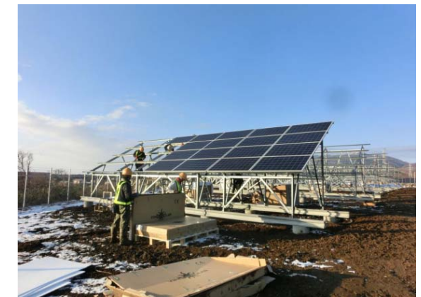
■ いちご室蘭八丁平ECO発電所(北海道) (2014年2月竣工予定)
