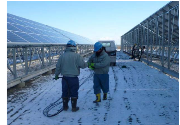
■ いちご元紋別ECO発電所(北海道) (2014年1月竣工予定)
