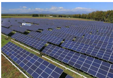
いちご中標津緑ヶ丘ECO発電所
