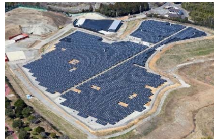
いちご津 ECO発電所
