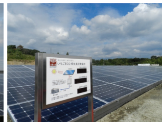
いちごECO桐生奥沢発電所
