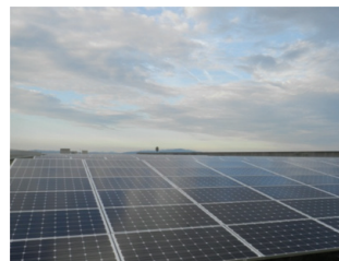
いちごECO徳島東沖洲発電所
