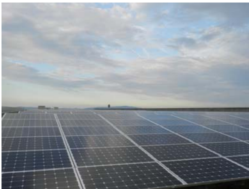
■ いちごECO徳島東沖洲発電所(徳島県)
