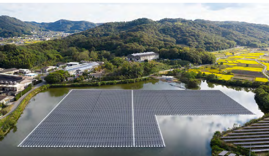
いちご笠岡岩野池 ECO 発電所 いちごによる 2 件目の水上太陽光発電所も 2019 年の完成に向け進行中
