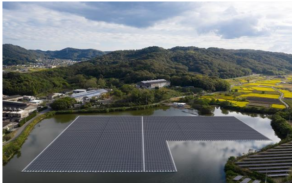
いちご笠岡岩野池ECO発電所
